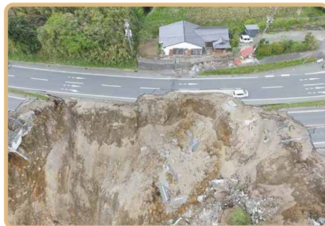
地震によってくずれ落ちた道路
